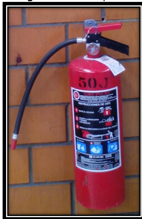
Imagen 27. Extintor tipo PQS
