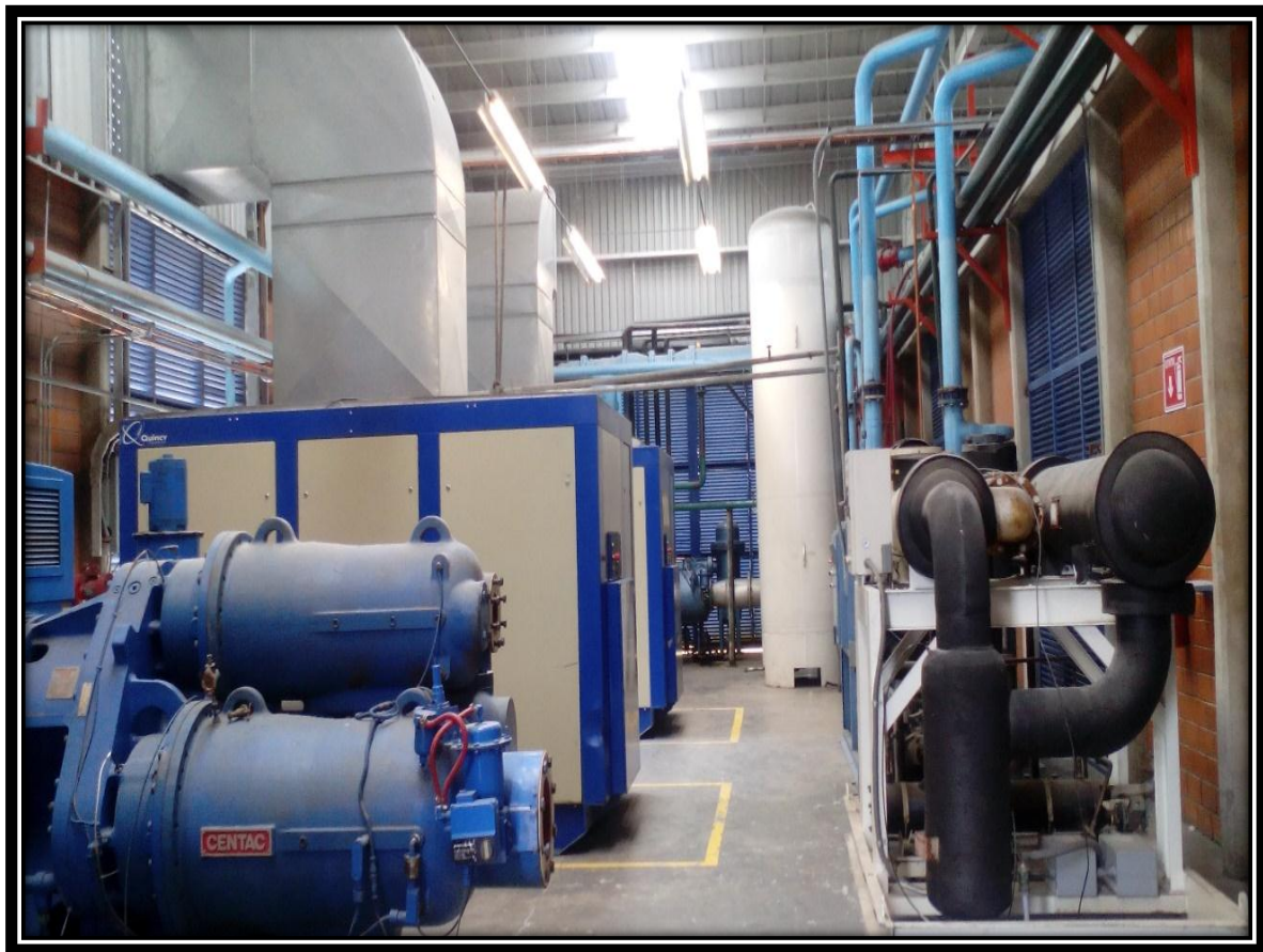
Fotografía 4. Área de compresores
